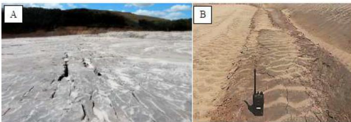
Figura 10 - Imagem das trincas de tração paralelas à crista, dentro do reservatório (A) e das trincas de compressão no patamar do eixo recuado (B). (Disponível em: < http://www.mpf.mp.br/mg/sala-de-imprensa/docs/denuncia-samarco >. Acesso em: 18 ago 2020.)
